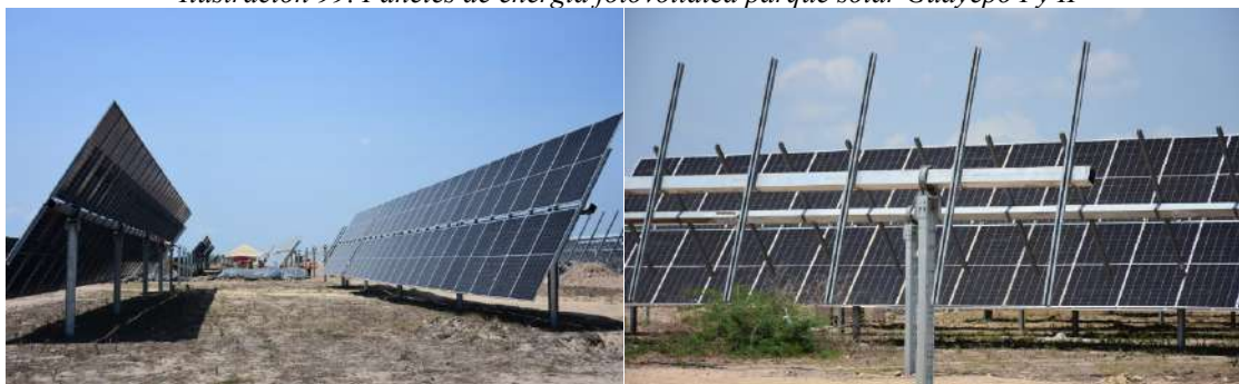
Ilustración 99. Paneles de energía fotovoltaica parque solar Guayepo I y II
