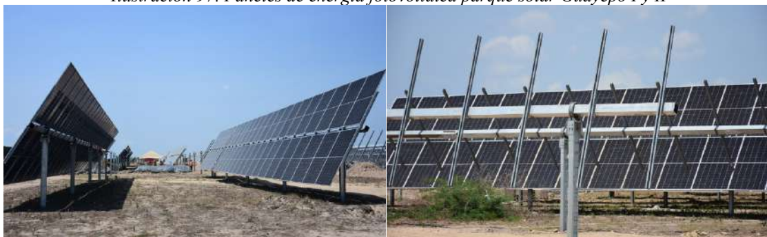
Ilustración 97. Paneles de energía fotovoltaica parque solar Guayepo I y II
