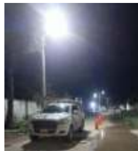
Luminarias led en Campo de la Cruz
