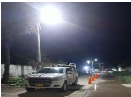
Luminarias led en Campo de la Cruz
