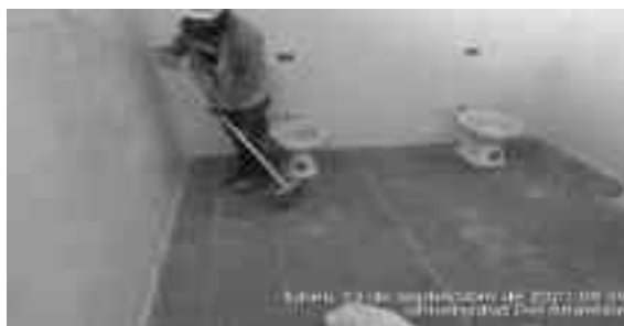
BATERIA DE BAÑOS
