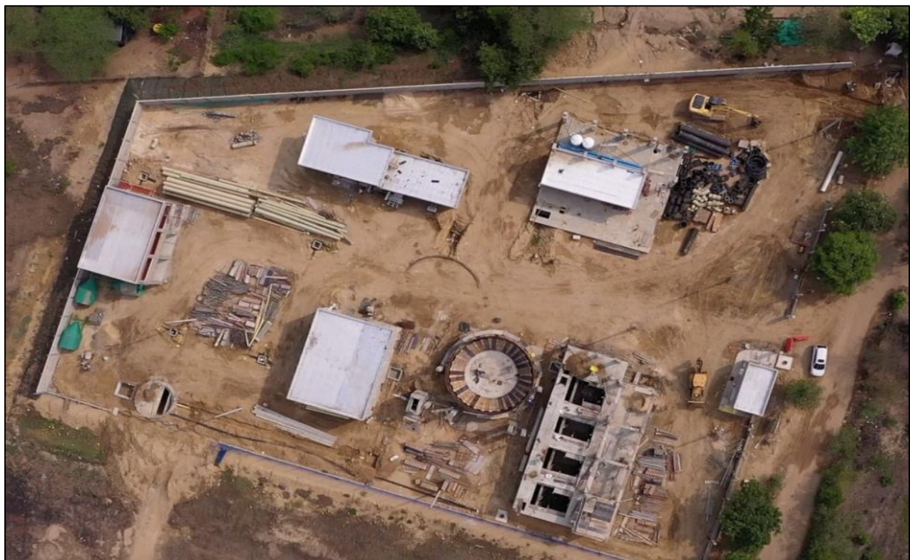
Descripción: Vista superior planta de tratamiento de agua potable.
