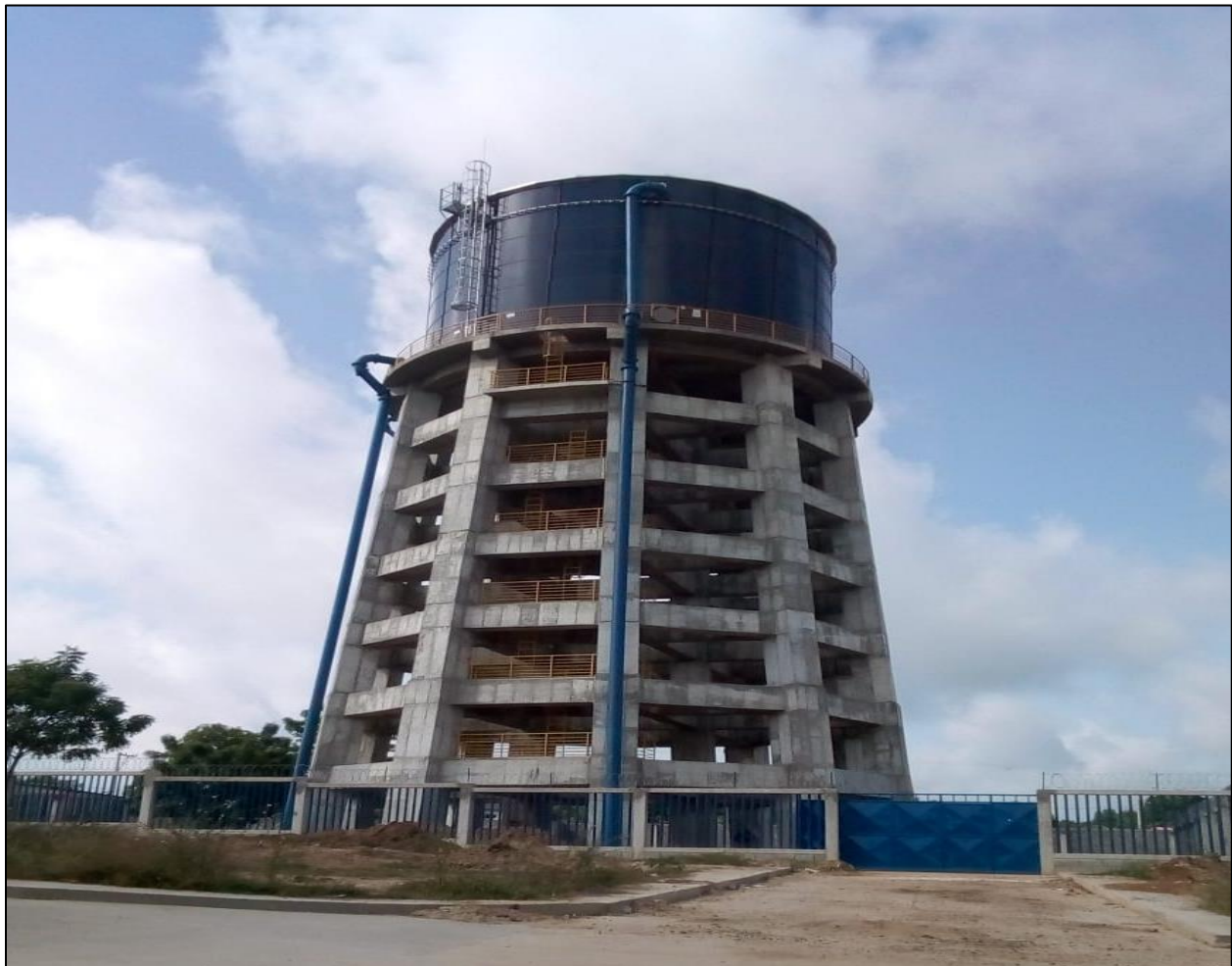
Descripción: Tanque elevado. 1.500 M3
