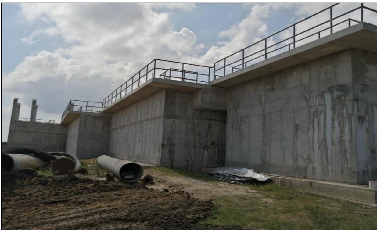
Descripción: Planta de tratamiento de agua potable.
