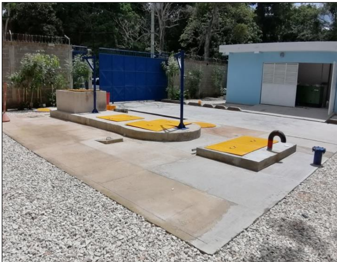
Descripción: Estación de bombeo
