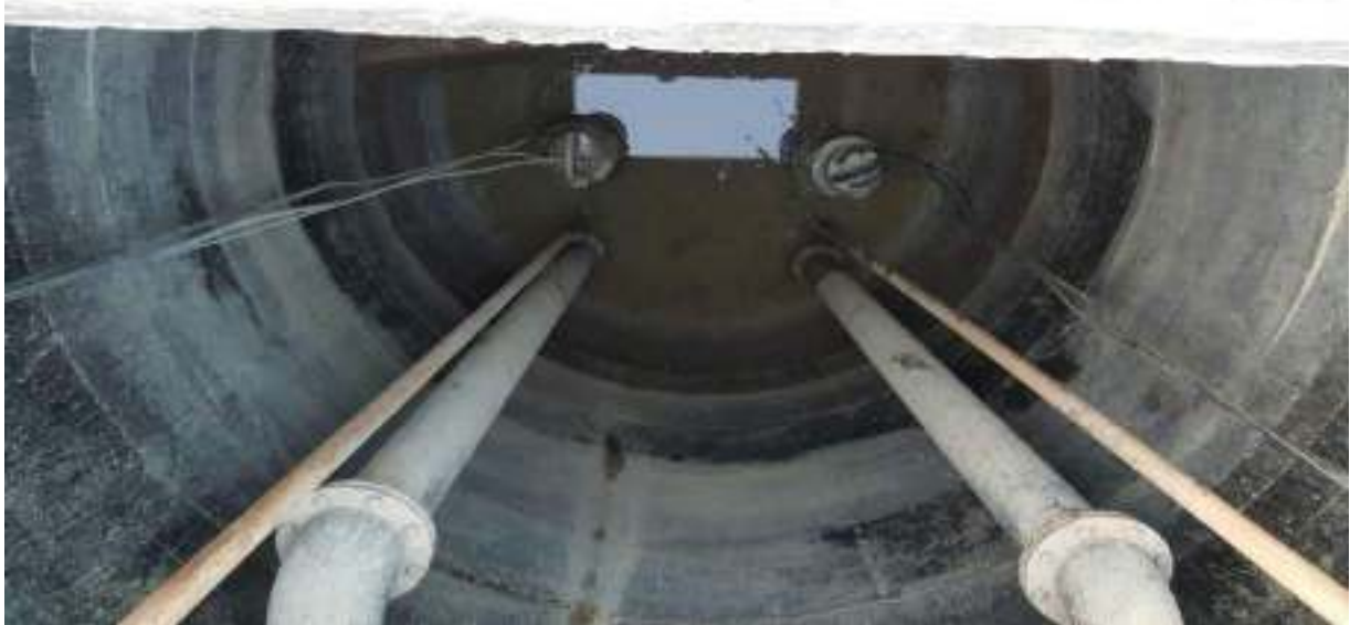
POZO ALCANTARILLADO DE SALGAR
