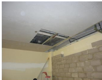
Cielo Raso en Dry Wall y Aire Acondicionado Nuevo.
