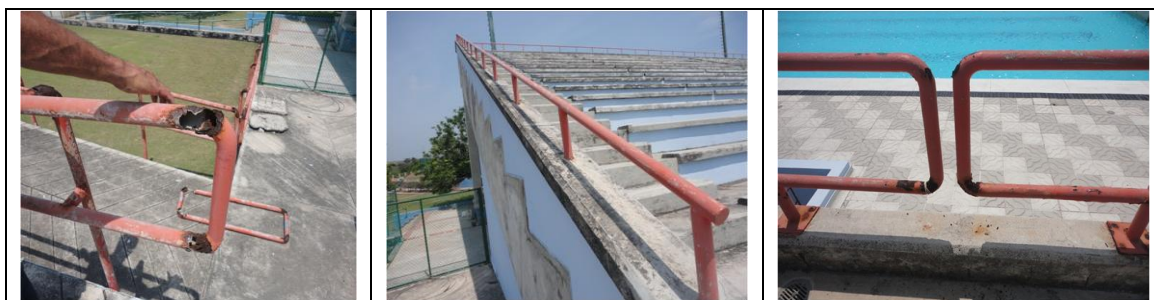
Estado de la barandas de protección de la piscina.
