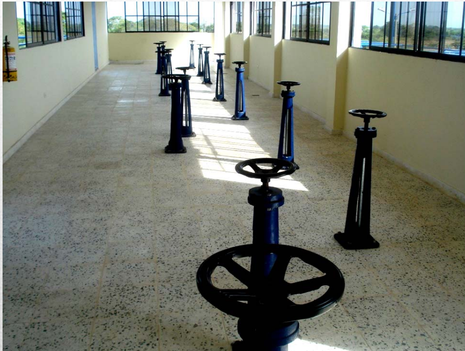
Galería de Filtros
