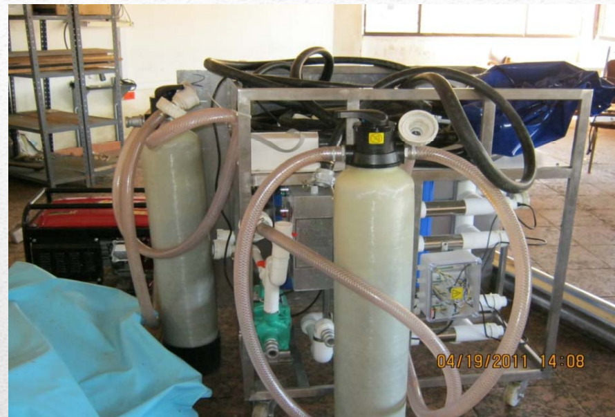
PLANTA DONADA POR PIES DESCALZOS INSTALADA EN SANTA LUCIA
