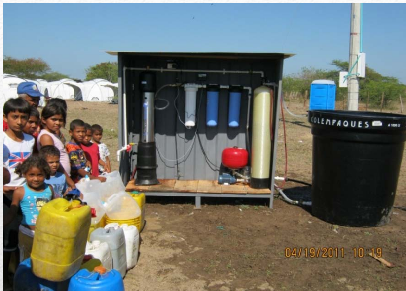
PLANTA DONADA POR PACIFIC RUBIALES INSTALADA EN EL ALBERGUE DE BOHÓRQUEZ
