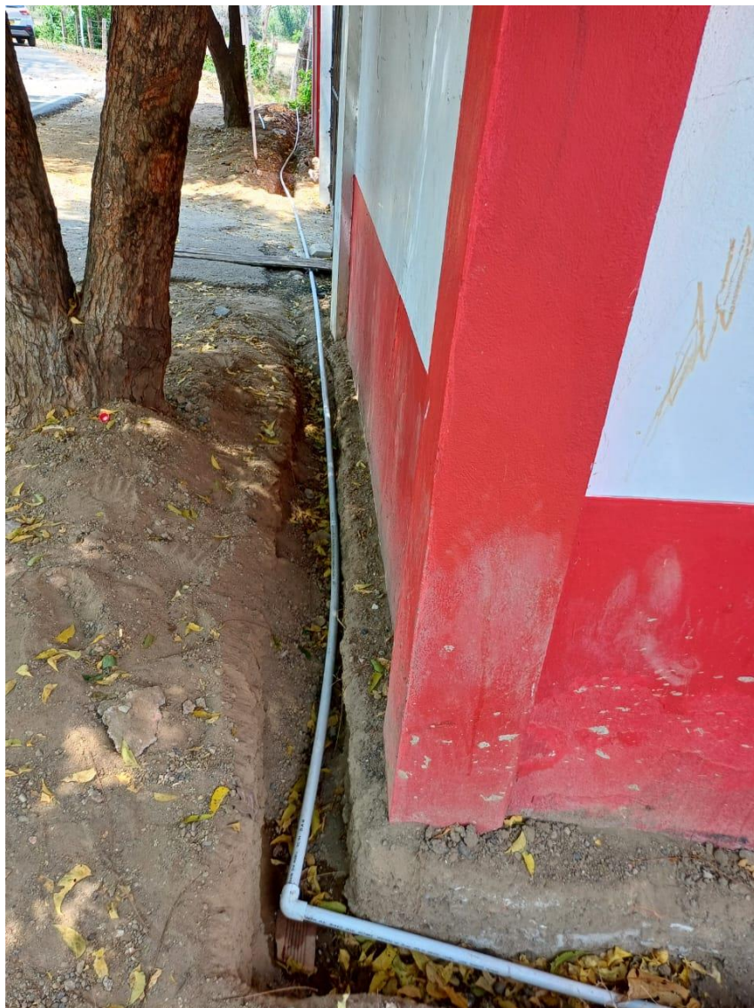
Acometidas en PVC para agua potable, sede # 3
