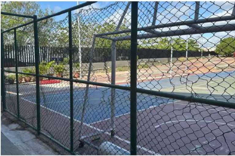
Estado de la Malla de Protección en la cancha principal (Antes)
