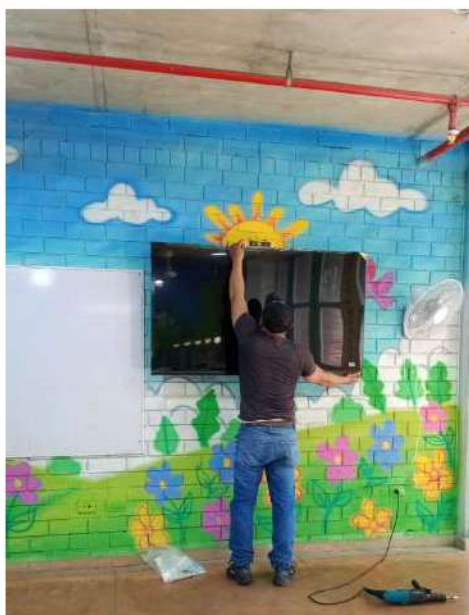
Instalación de Televisores en los Salones
