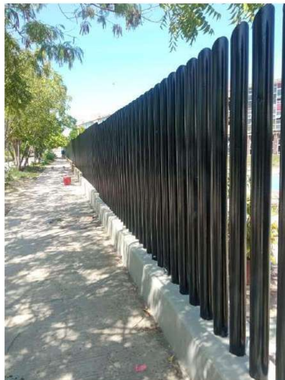
Mantenimiento Tubos externos de encerramiento
