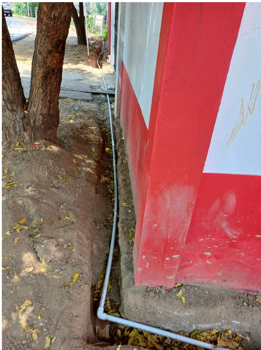
Acometidas en PVC para agua potable
