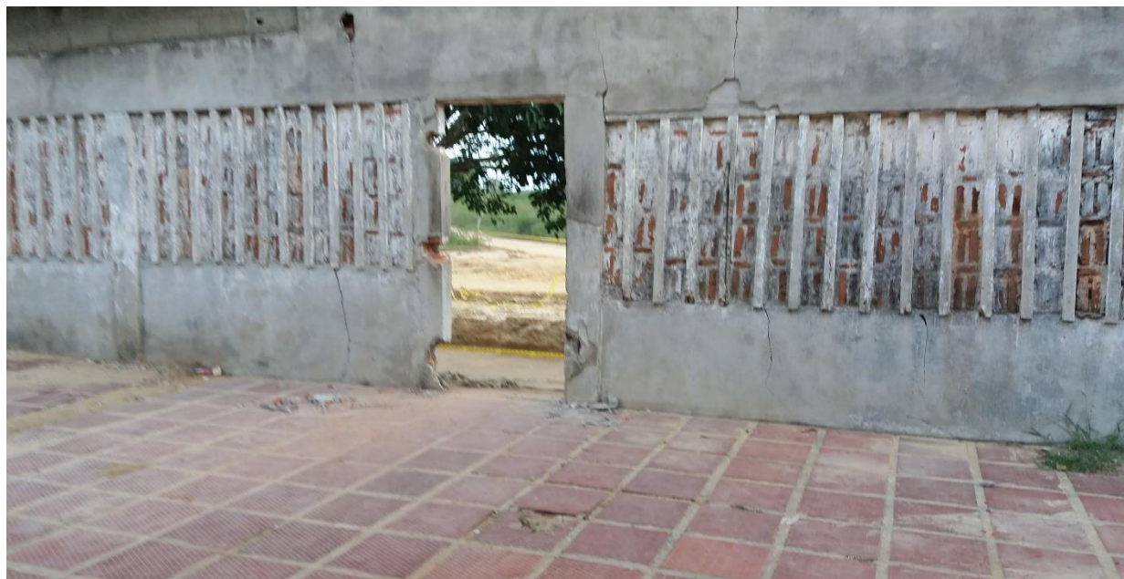
Traslado de la puerta de ingreso por daño en la pared
