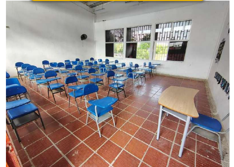
Instaladas en aula
